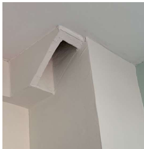
Figur 4: Således kan udluftningskanaler fremstå
